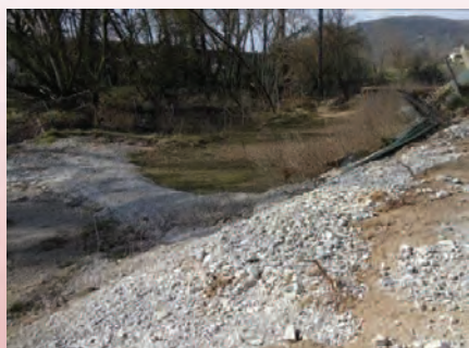
Erosion accès estacade Pech rive gauche FSE n°30 04/03/21
