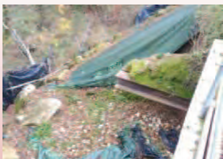
Estacade Pech rive gauche (bâche arrachée)
